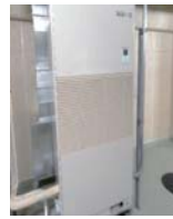
空調設備更新による 高効率化
